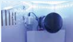
送風機とLED照明
